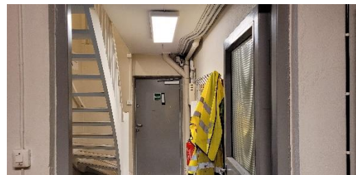
Figur 3. Tretrapp må oppgraderes.
