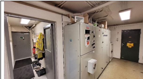
Bygg 1 utført som branncelle: Teknisk rom/tavlerom som tilstøter rømningsvei og dør ned til garasje.
