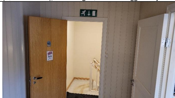
2.etg.: Trapperom (rømningsvei) mangler brannklasse mot tilstøtende rom (vegger og dører EI 2 30 CSa [B 30S]).
