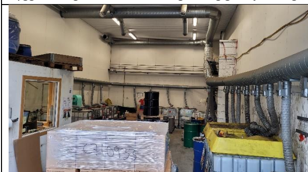
Bygg 4 og lager, må oppgradere vegg på venstre side.
