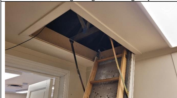
2.etg.: Luke til loft mangler brannklasse EI 30 [B 30].
