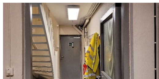
Figur 3. Tretrapp må oppgraderes.
